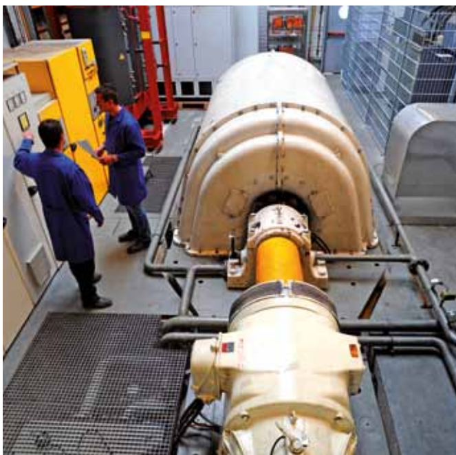
Alternateur de puissance instantanée 100 MVA Caractéristiques d'essais : 100 kA/440 V, 80 kA/525 V, 50 kA/725 V 100 kA 1 seconde, 50 kA 3 secondes
