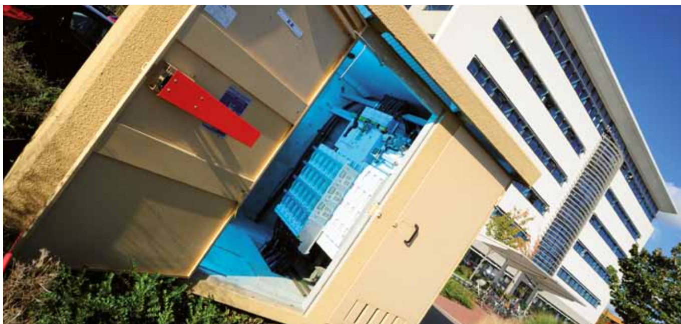
Poste HTA/BT du réseau de distribution avec TUPI SOCOMEC
