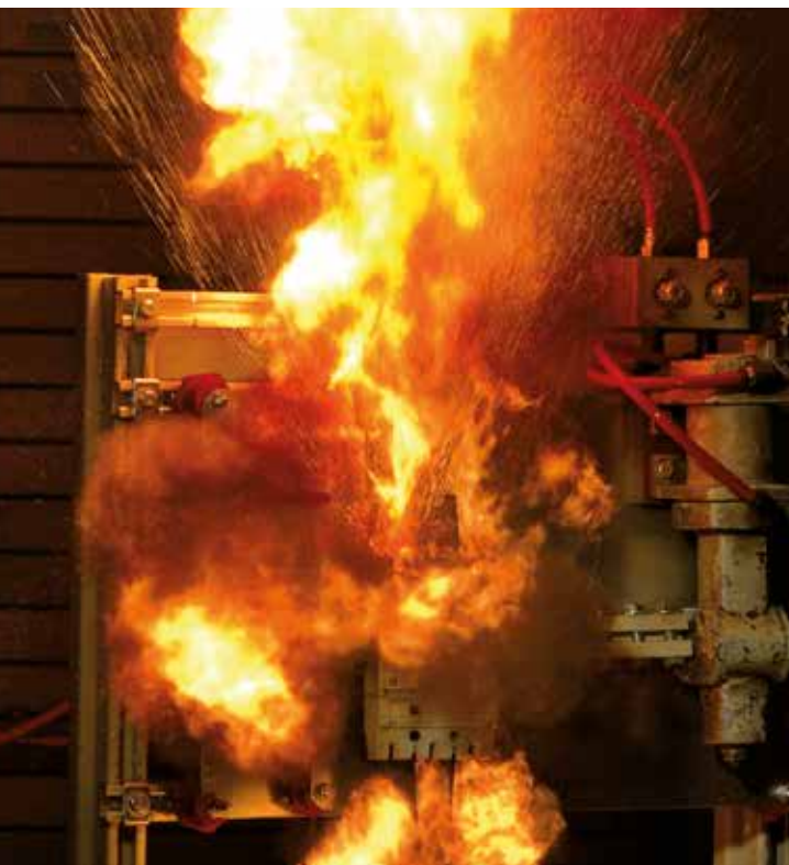
Disjoncteur 250 A neuf, de conception récente testé à 18 kA 415 VAC. Hauteur de la gerbe de dégazage : 3 mètres. - Icu du Disjoncteur testé : 36 kA.
