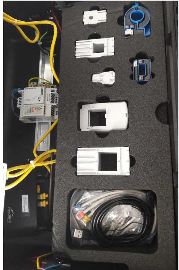
Intérieur : Capteurs AC et DC, alims AUX et routeur
