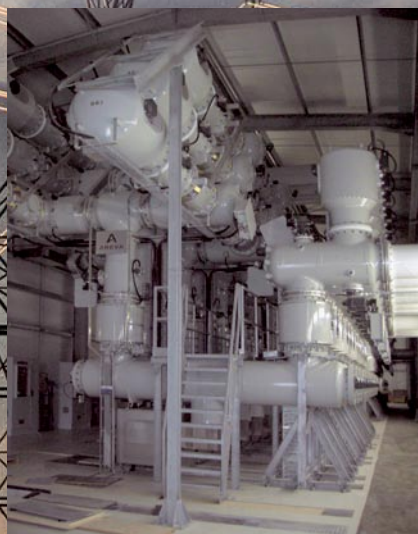
Photo d'une sous-station blindée 400KV en Lybie (AREVA)
