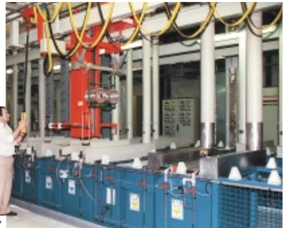
La puissance installée dans un atelier doit pouvoir être fréquemment redimensionnée...
