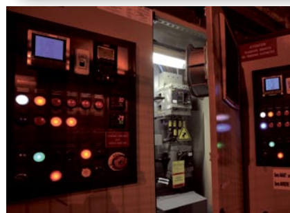
Long de près de 1600 m, le tunnel de Monaco (sur l'A500) vient d'être rénové, en particulier au niveau de la ventilation, de l'éclairage et de la sécurité de l'alimentation électrique.
