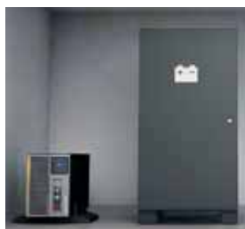
Posé au sol Adaptable à l'espace disponible
